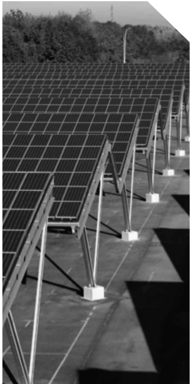
Les ombrières du parking du Parc des Expositions de Bordeaux en images. © Photographie : Arnaud Lombard / EDF EN
